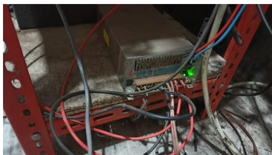
Gambar 22. Accu genset terhubung UPS
