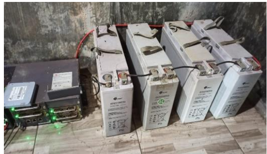
Gambar 23. Baterai pada UPS
